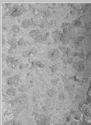
Korozja przy wysokim zasoleniu
